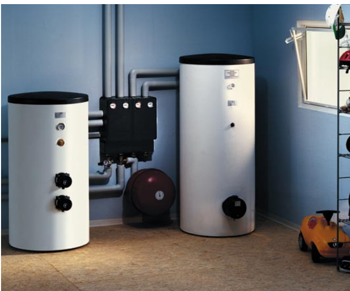
Pufferspeicher, Heizkreisverteiler und Warmwasserspeicher komplettieren die Luft/Wasser-Wärmepumpenanlage
