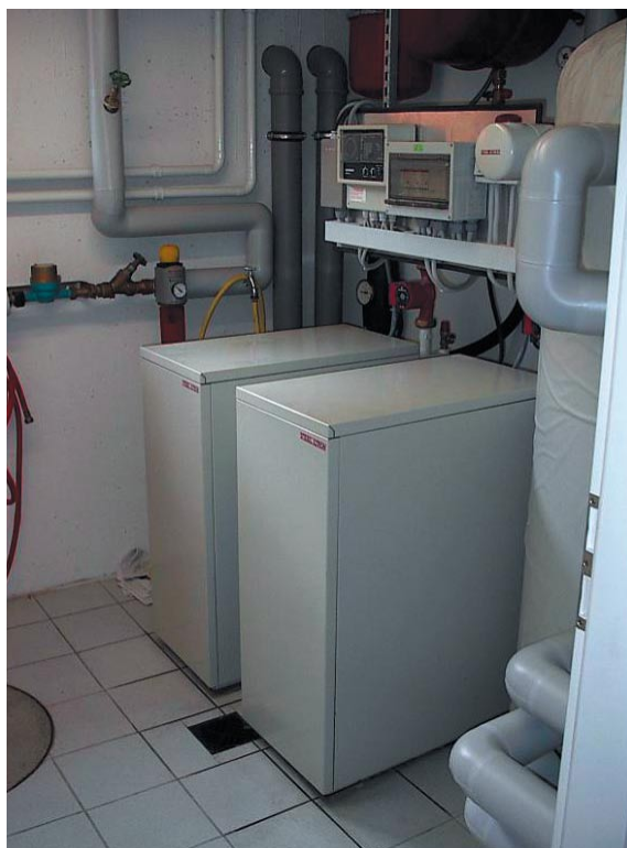
Heizungsraum mit Wärmepumpen und Speicher.
